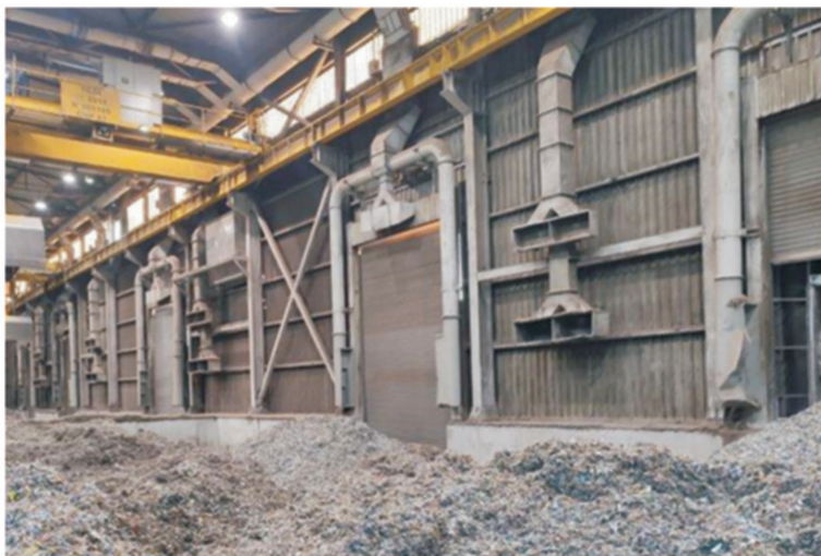
Ryc. 9. Przykład instalacji wentylacyjnej przy składowaniu paliwa RDF w cementowni (fot. Mirosław Kubicki)
