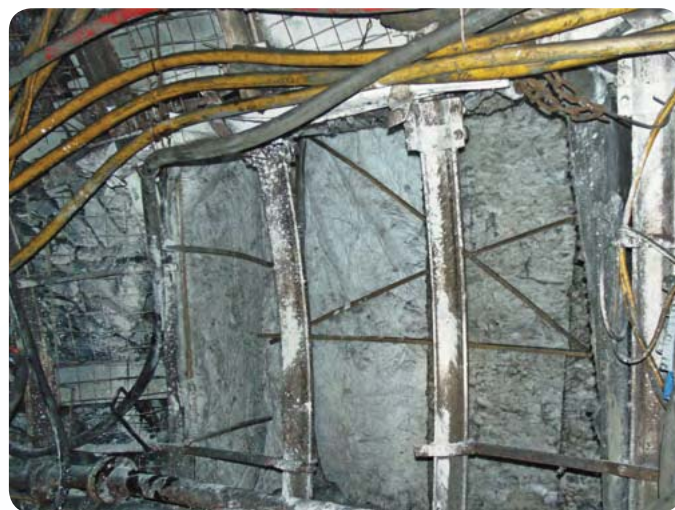
Fot. 2. Widok zaprojektowanego i wykonanego miejsca pracy obsługi przenośnika taśmowego w dowierzchni 7. badawczej pokład 503 po aplikacji materiału dźwiękochłonnego
