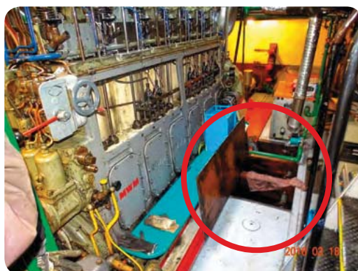
Fot. 2. Siłownia Ms Andromeda – otwarty właz w rejonie silnika głównego Photo 2. Ms Andromeda's engine-room – an open hatch in the main engine's area
