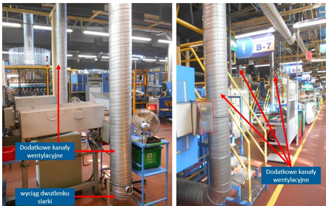
Przykłady wyciągów miejscowych odprowadzających dwutlenek siarki z obszaru maszyn produkujących komponenty
