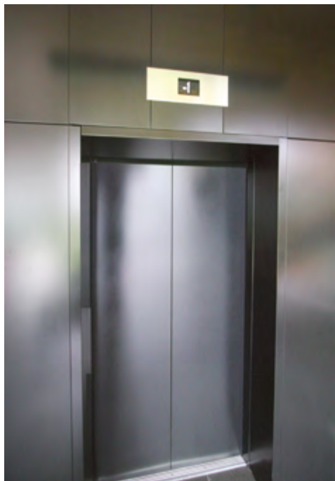
Rys. 8-1. Duży i kontrastowy wyświetlacz informacyjny, zamontowany nad drzwiami do kabiny dźwigu osobowego
