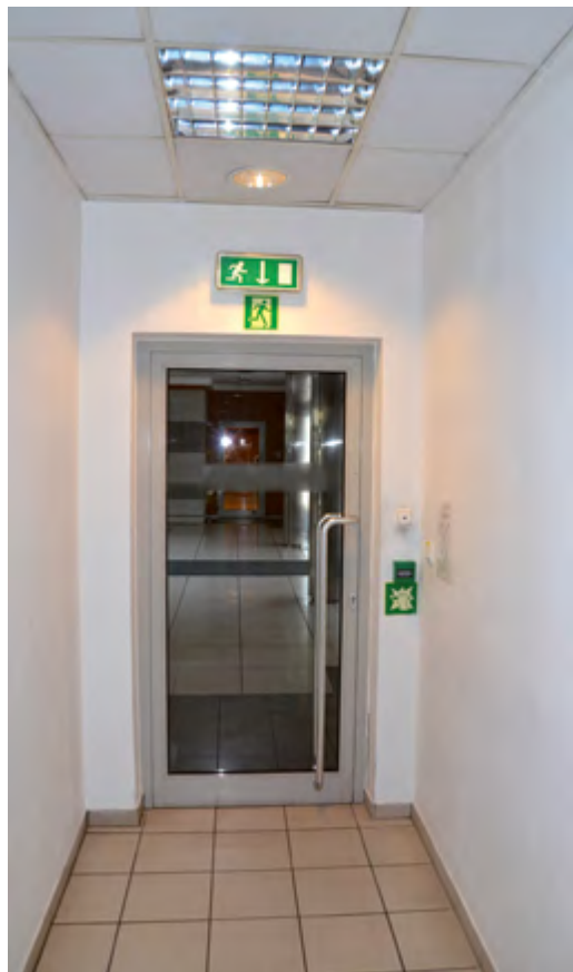
Rys. 32-1. Włączona na stałe oprawa oświetleniowa umieszczona nad drzwiami ewakuacyjnymi w korytarzu
