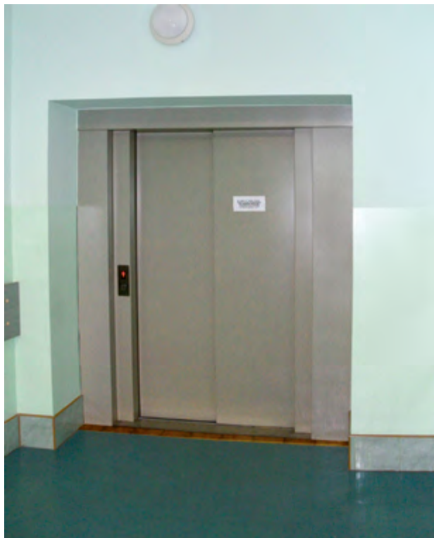
Rys. 5-1. Drzwi do kabiny dźwigu osobowego o kontrastowej barwie względem ściany oraz podłogi przed drzwiami
