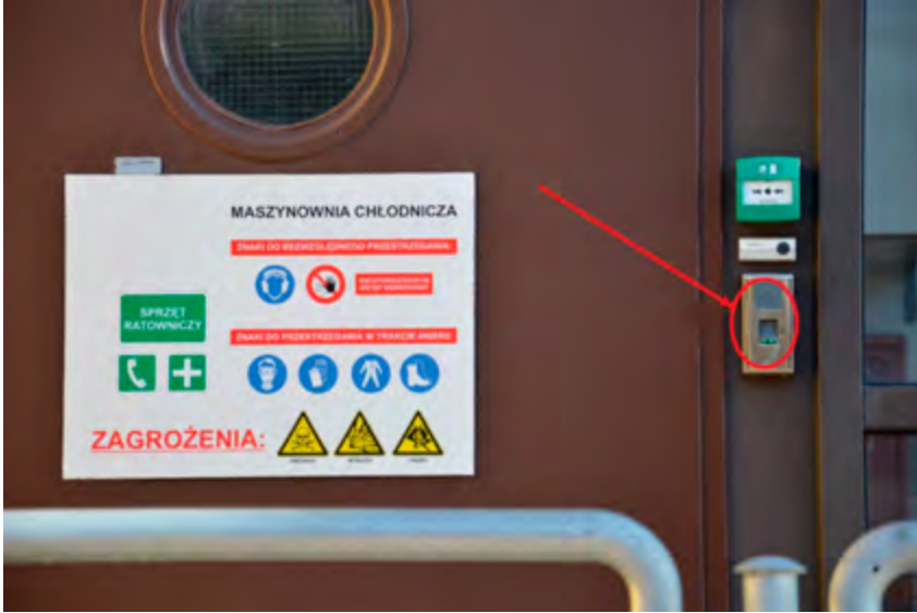
Rys. 42-1. Urządzenie dostępu do pomieszczenia wyposażone w sygnalizację dźwiękową oraz świetlną
