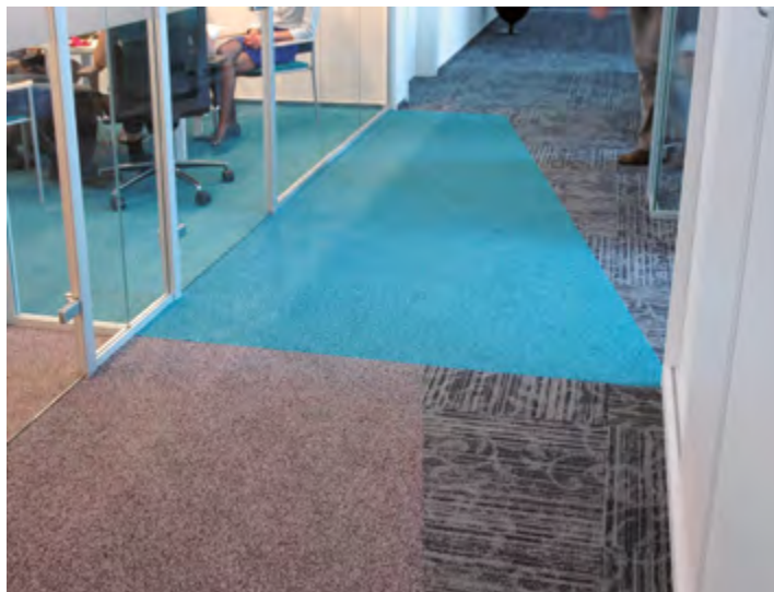
Rys. 22-1. Zróżnicowana barwa wykładziny podłogowej w sali konferencyjnej względem barwy wykładziny korytarza i innych pomieszczeń
