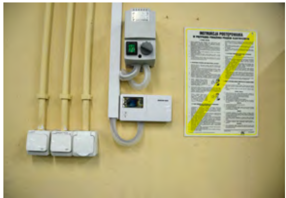
Rys. 78-2. Panel sterowania klimatyzatorem na wysokości włączników oświetlenia
